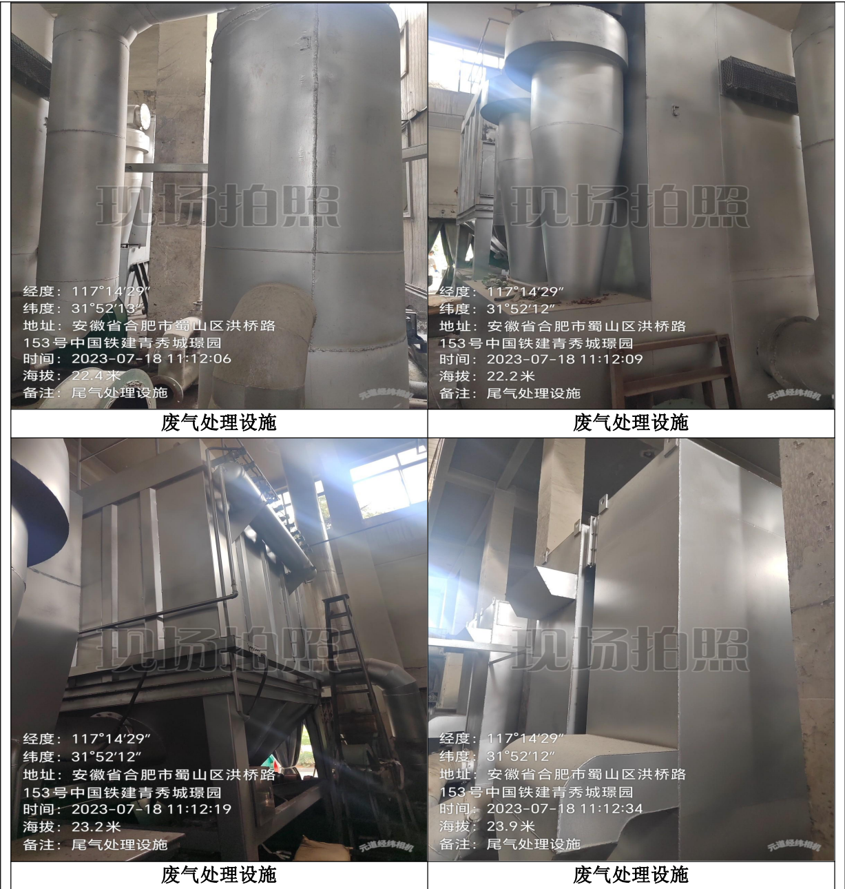
图 3-1 废气处理设施
